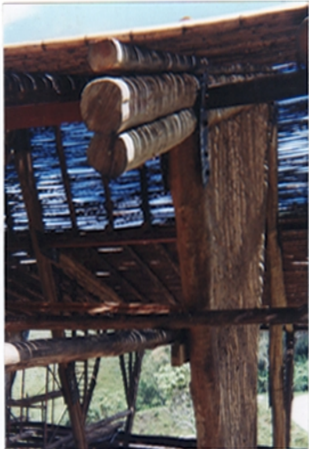
FIGURA 3. Vista frontal del pórtico formado por doble fuste de teca y pared de bahareque
