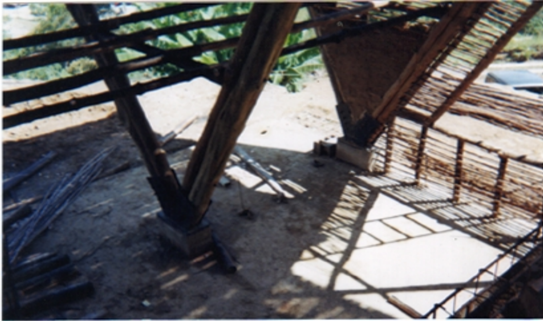
FIGURA 4. Vista de arranque de los pórticos de madera rolliza de teca y la estructura del bahareque
